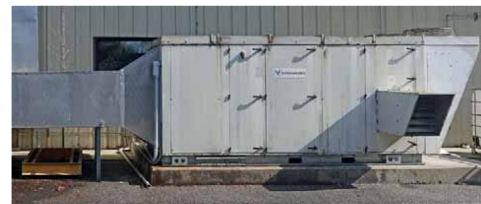
Klima- und Raumluftreinigungsanlage mit Wärmerückgewinnung (2016)
