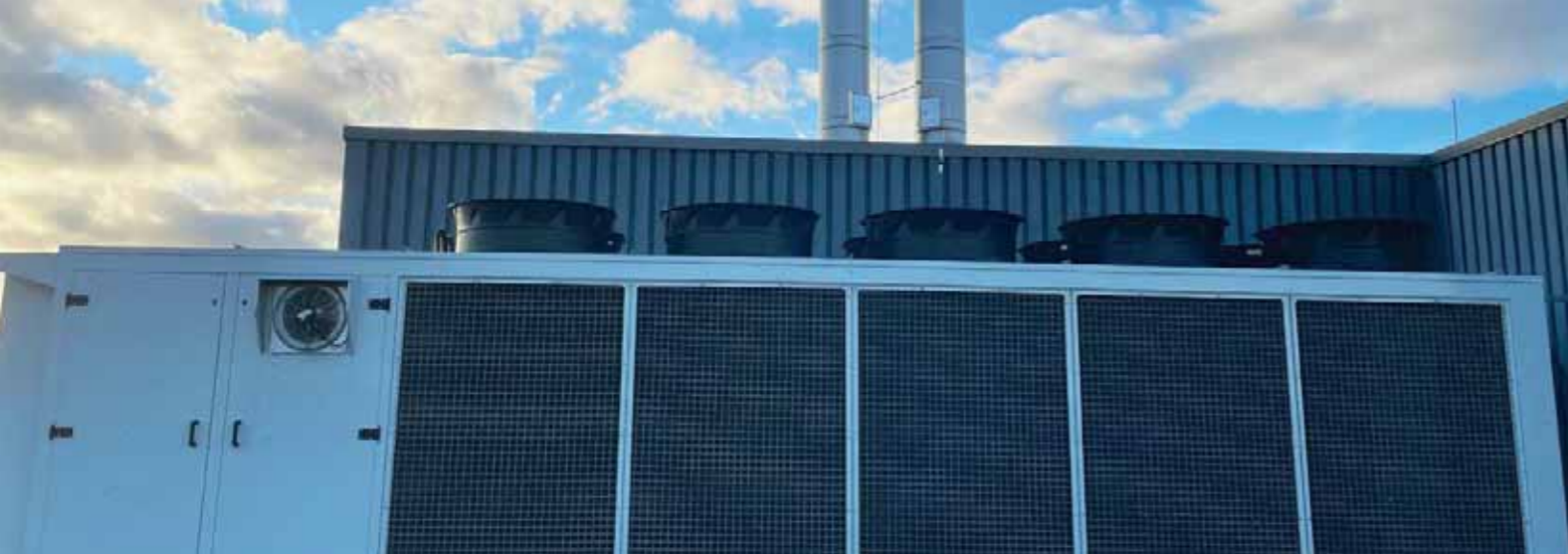
Abb. oben: Installierte Kälteanlage für Kühlprozesse in der Produktion (2021); Abb. links: Abluftreinigungsanlage mit Wärmerückgewinnung
